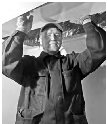
Столяр А.Г. Кривуша устанавливает потолочную панель в помещении каютелярии на палубе юта танкера RST27 (строительный №13)
